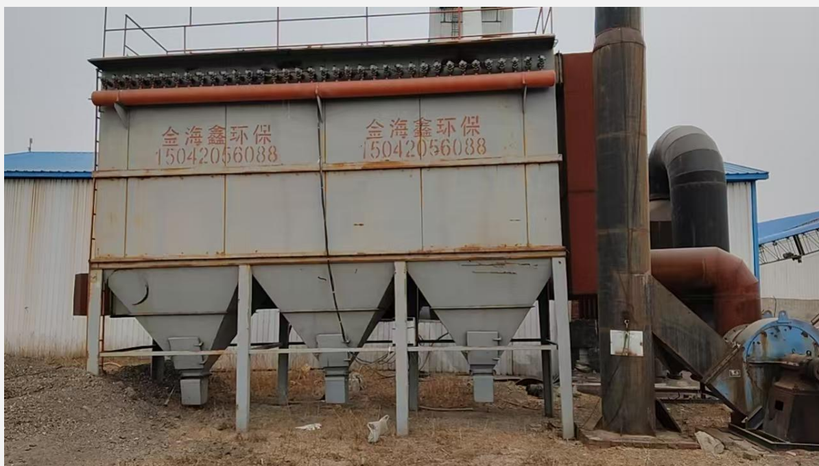
生物质锅炉配套布袋除尘器
