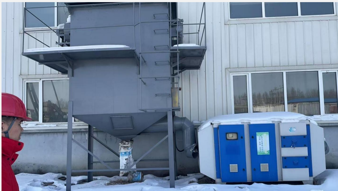
喷焊工序环保措施（布袋除尘器）
