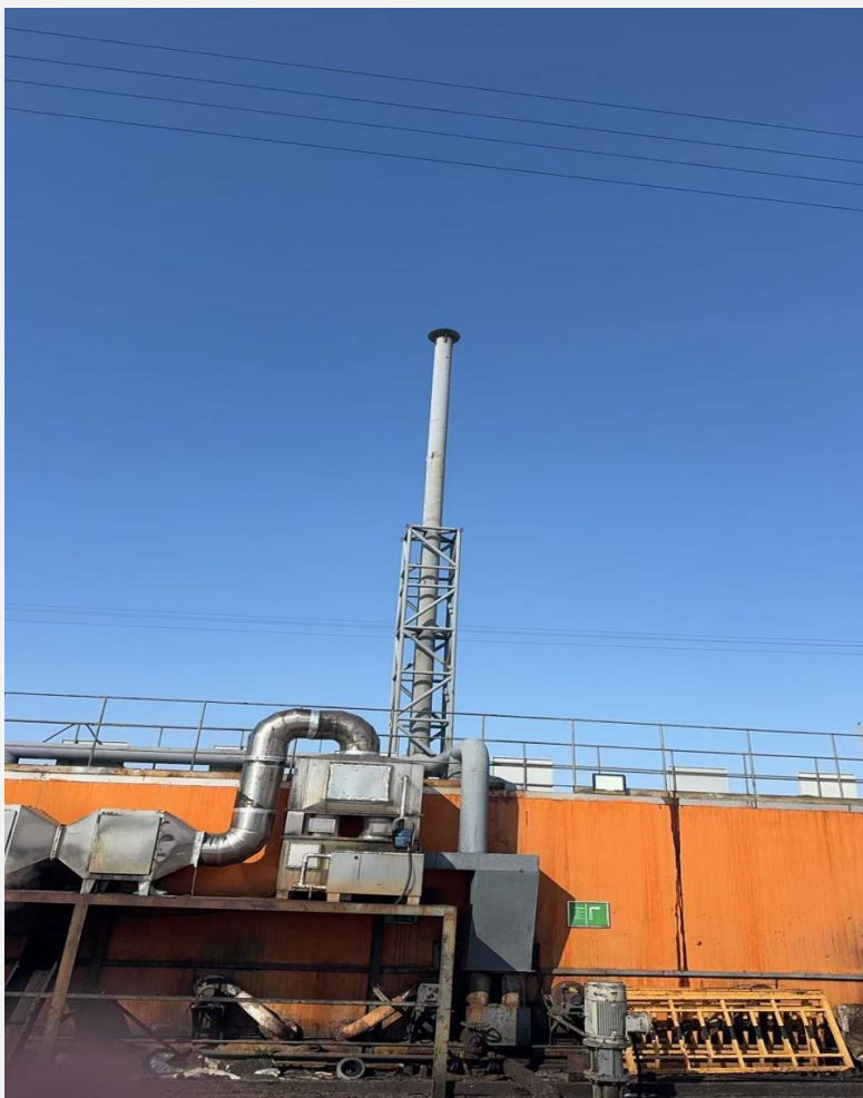
燃气锅炉 15 米高排气筒和环保措施（水喷淋加活性炭吸附）
