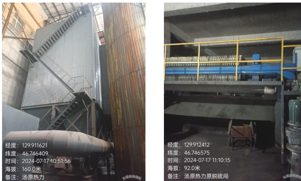
现有锅炉除尘脱硫系统（2024.7）
