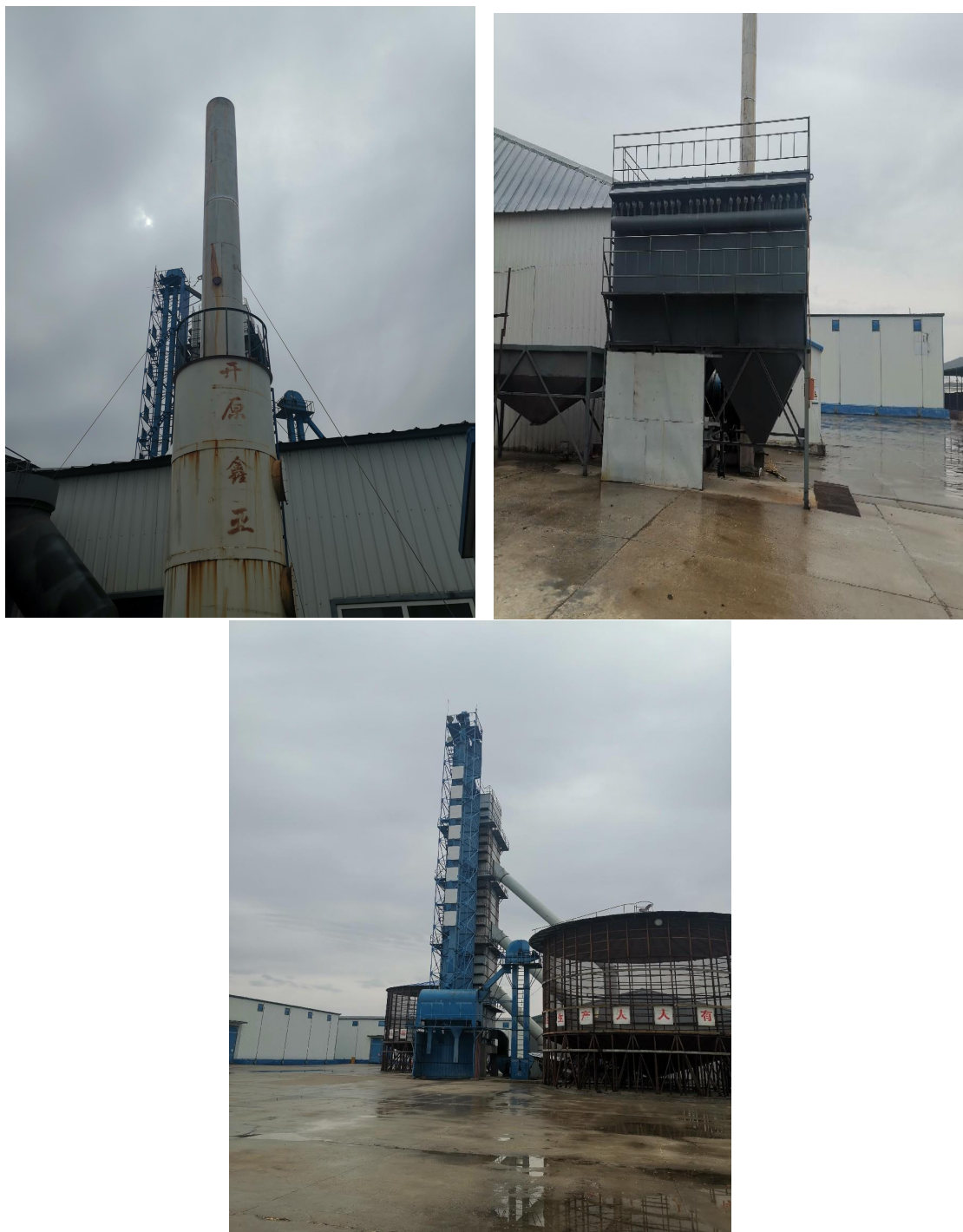
烘干塔 1#及配套治理措施
