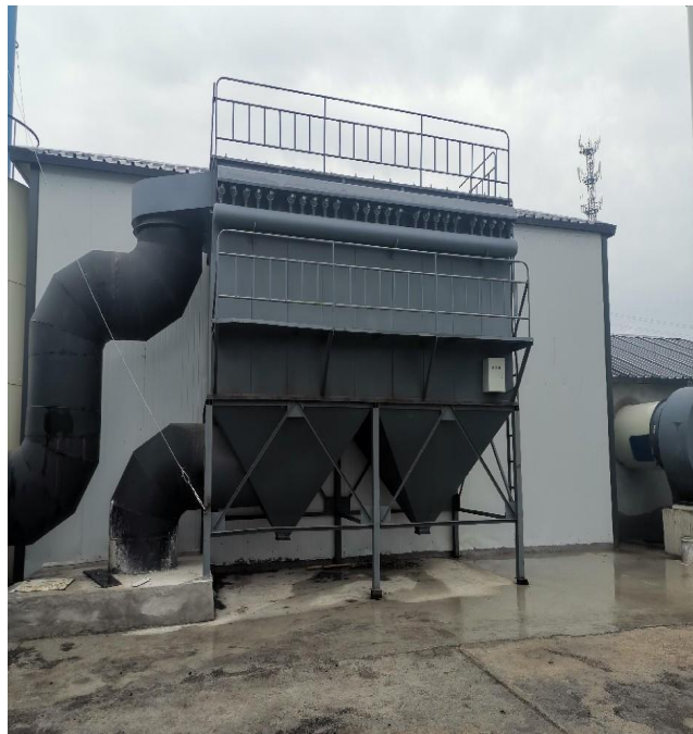
烘干塔 2#及配套治理措施
